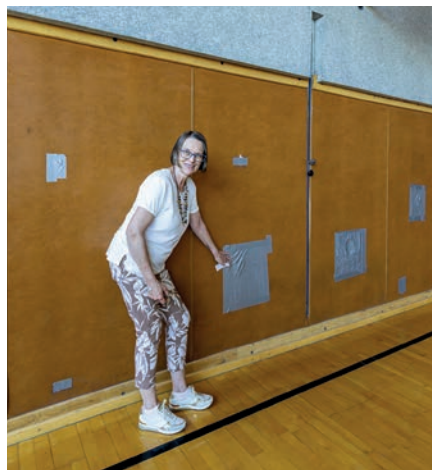
Im Turnsaal ist eine Erneuerung der Wandbespannung dringend erforderlich.
